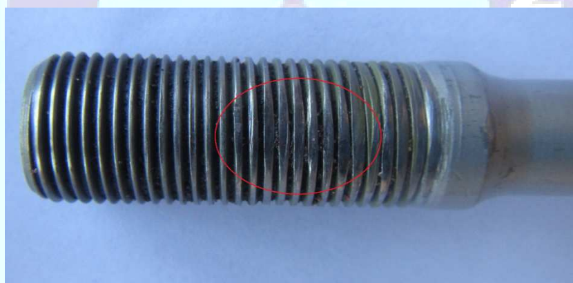
Figura 3 -Detalhe do fio de rosca do garfo desgastado.
