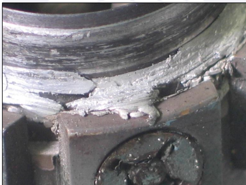
Figura 16 - Metal derretido (fusão) depositado na conexão entre os eixos
