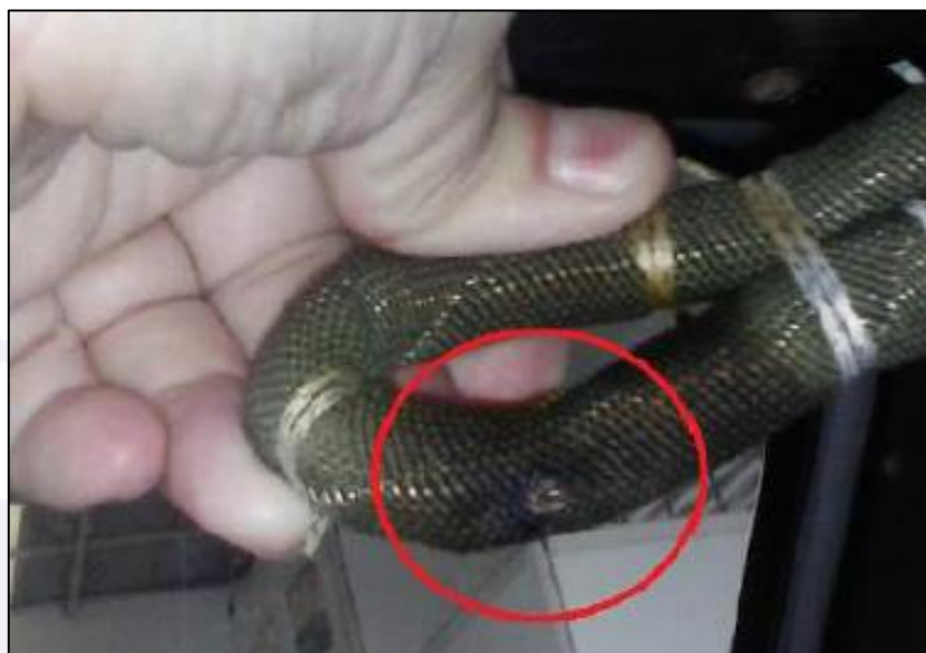
Figura 2 - Marcas do sobreaquecimento e o furo na cablagem.
