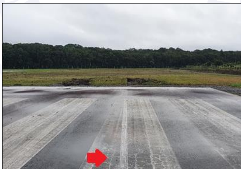
Figura 6 - Marca deixada pelo pneu da aeronave sobre a faixa da cabeceira oposta ao pouso.
