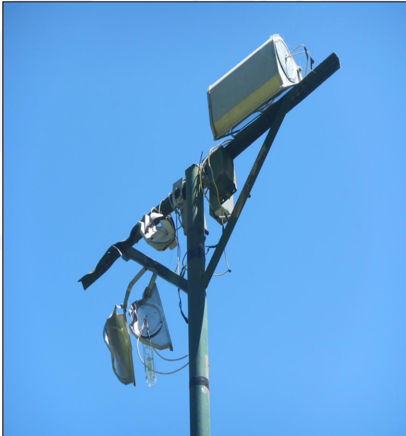
Figura 4 - Detalhe dos danos ao poste de iluminação atingido.
