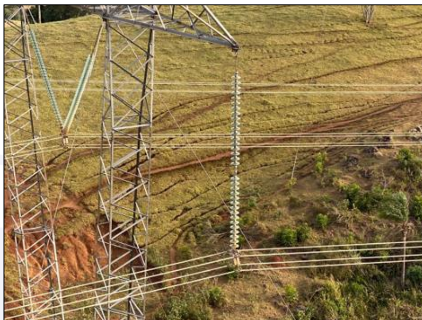
Figura 3 - Local da colisão entre o PP-PIT e a cadeia de isoladores da rede de transmissão de energia elétrica.
