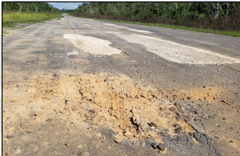
Figura 5 - Deterioração da pavimentação da pista em SSMH.
