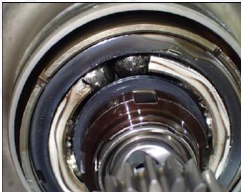
Figura 9 - Rolamento nº 2 em sua posição correta, porém danificado.
