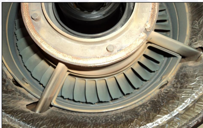
Figura 2 - Foto da seção de turbinas.
