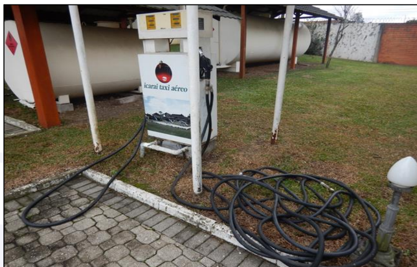
Figura 5 - Reservatórios de combustível de SSSE.
