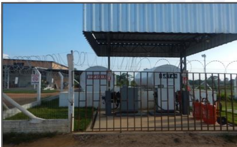
Figura 7 - Posto de armazenamento do Etanol da empresa com a inscrição de querosene de aviação (JET-A1).
