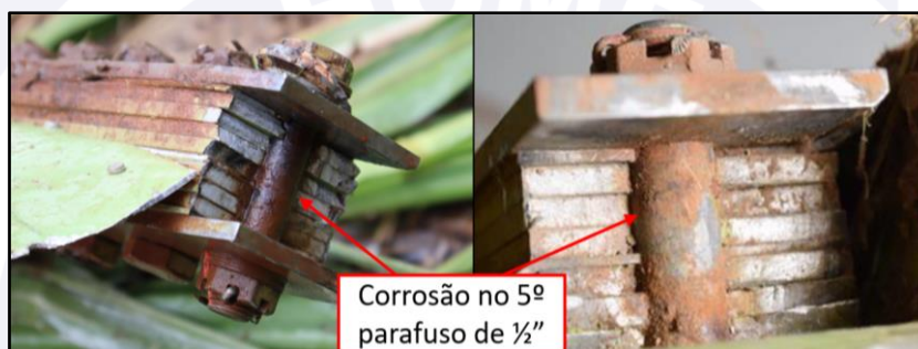
Figura 10 - Detalhe da região fraturada em serviço, com destaque para a corrosão nas chapas e região do quinto parafuso de \frac{1}{2} ".
