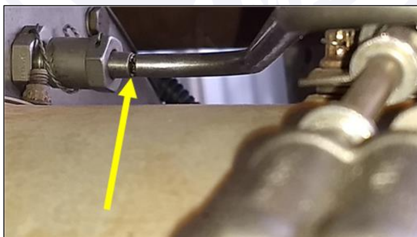
Figura 11 - Imagem da tubulação de Py. A seta amarela indica a parte danificada.
