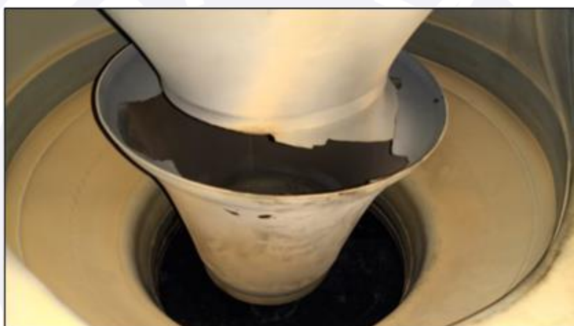
Figura 10 - Dano interno com perda de material no Exhaust Duct .
