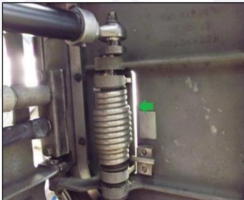
Figura 3 - Vista interna do small flap parcialmente aberto, após fechamento por acionamento elétrico.
