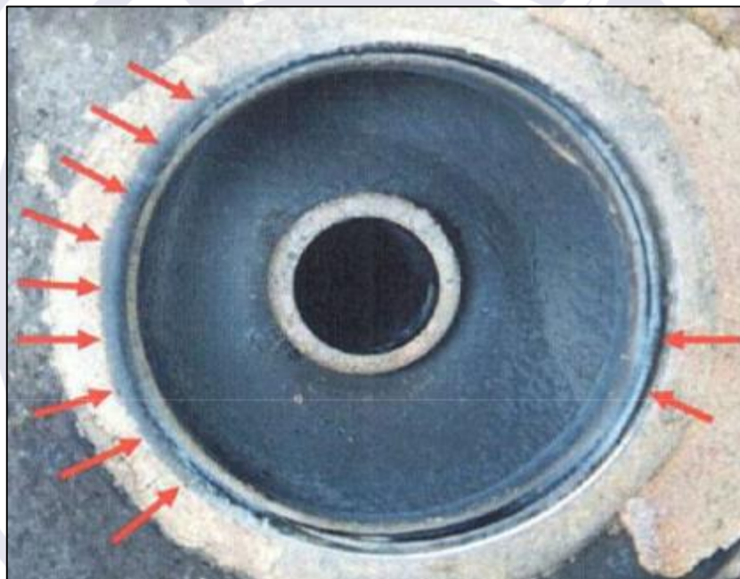
Figura 2 - Sede da válvula do cilindro nº 2, com destaque para a região onde ocorreu o vazamento.
