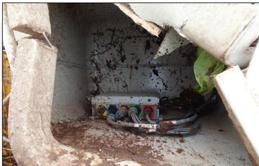
Figura 2 - Vista do DGPS Satloc instalado.
