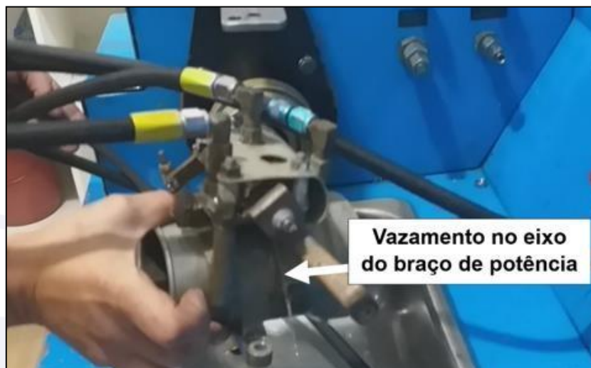
Figura 7 - Vazamento no eixo do braço de potência da controladora de combustível.
