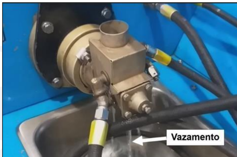
Figura 5 - Vazamento na bomba mecânica de combustível.
