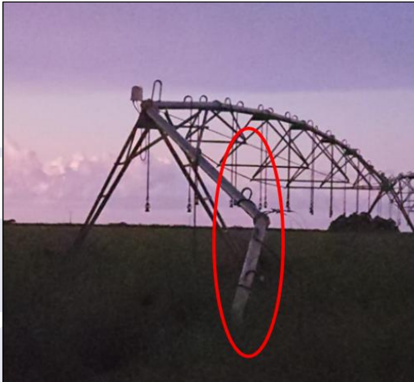
Figura 4 - Imagem do dano ao pivô de irrigação.
