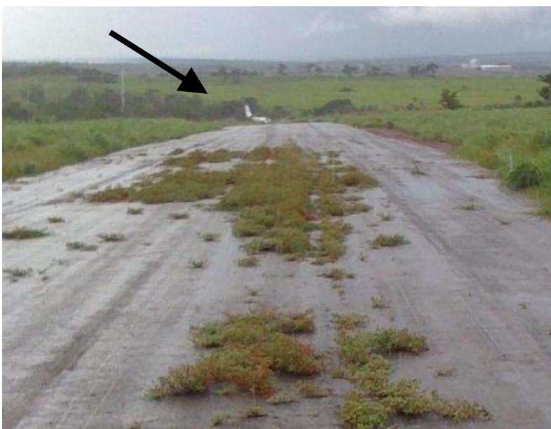
Foto 01 – Vegetação rasteira, que, aliada à chuva que havia caído horas antes, reduzia a aderência entre os pneus da aeronave (indicada pela seta) e a superfície da pista.
