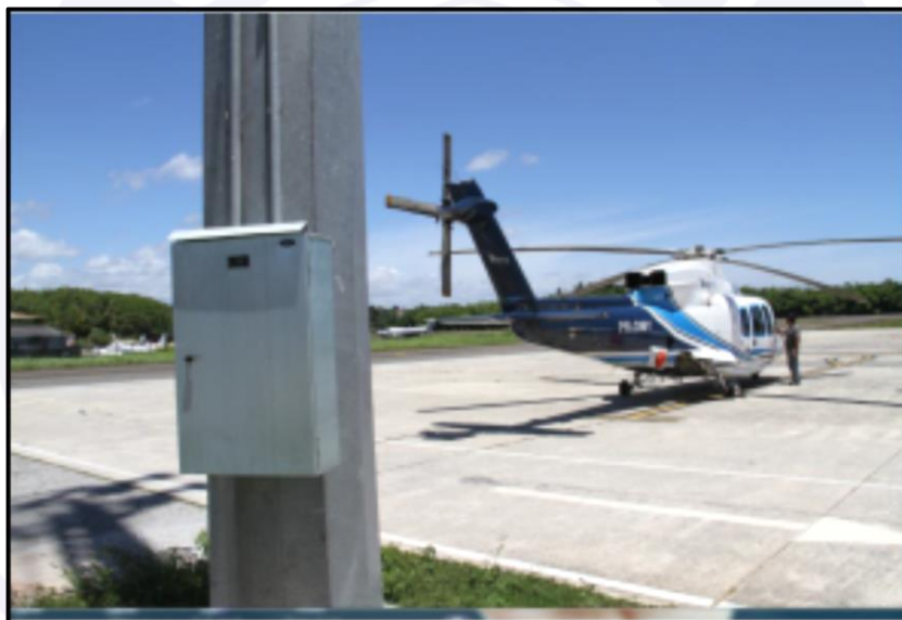
Figura 1 - Vista da aeronave estacionada na posição 06 do pátio 4 e da torre de iluminação atingida.
