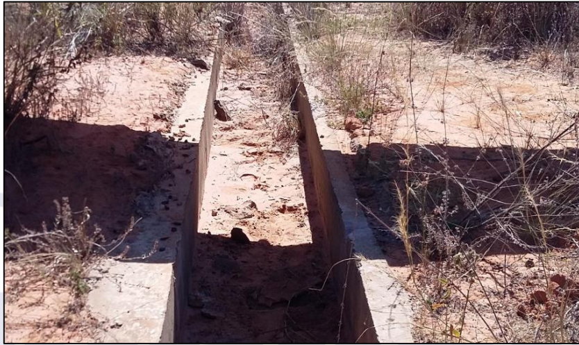
Figura 3 - Vala de escoamento de águas pluviais.
