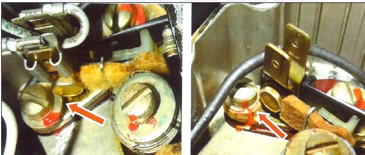
Figura 13 - Comparação entre a montagem do parafuso de fixação dos terminais elétricos do magneto direito do motor (arruela não prevista) e outro magneto similar (arruela correta).
