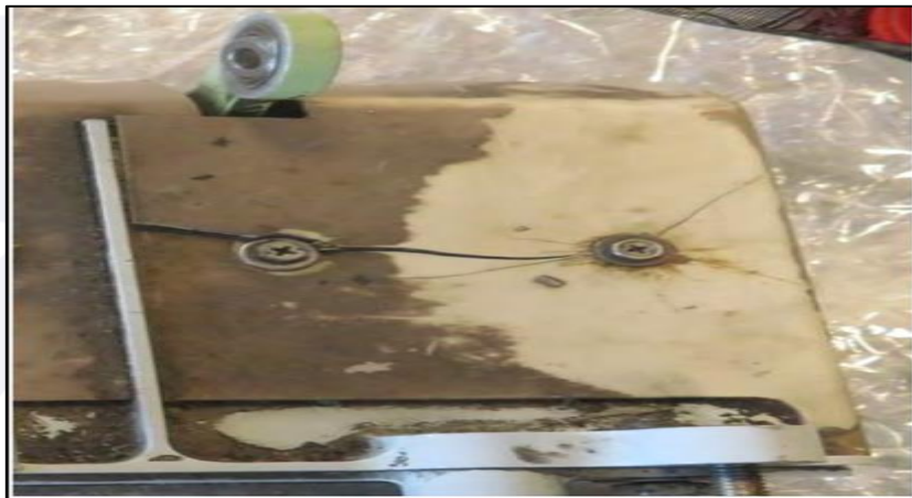
Figura 29 - Danos na cobertura de proteção da Microswitch Box .
