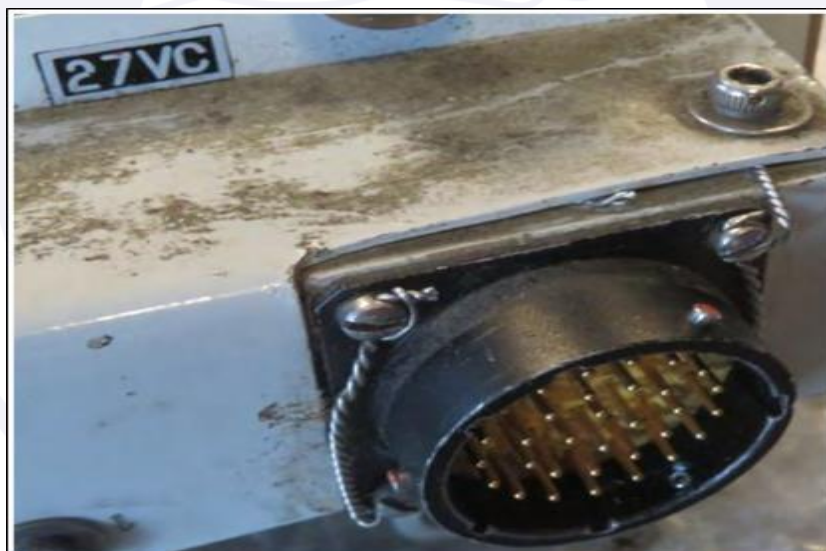
Figura 27 - Arame de Freio colocado por dentro da carcaça e conector em padrão diferente do previsto.
