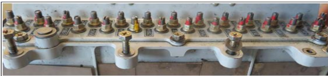
Figura 28 - Desalinhamento entre as marcações adesivas dos parafusos e das porcas das Microswitches .
