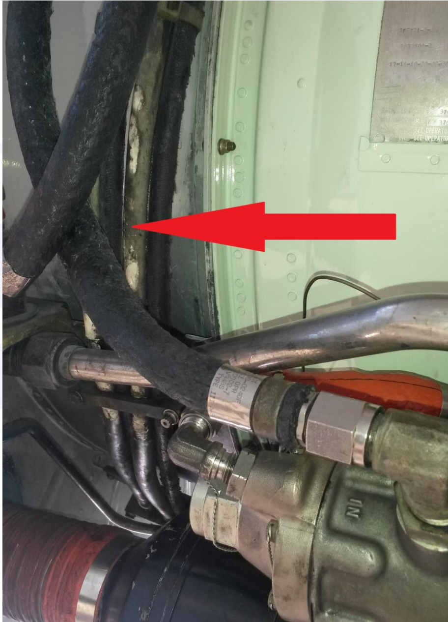
Figura 08 - Pontos de atrito da mangueira da bomba hidráulica de outra aeronave do mesmo modelo.
