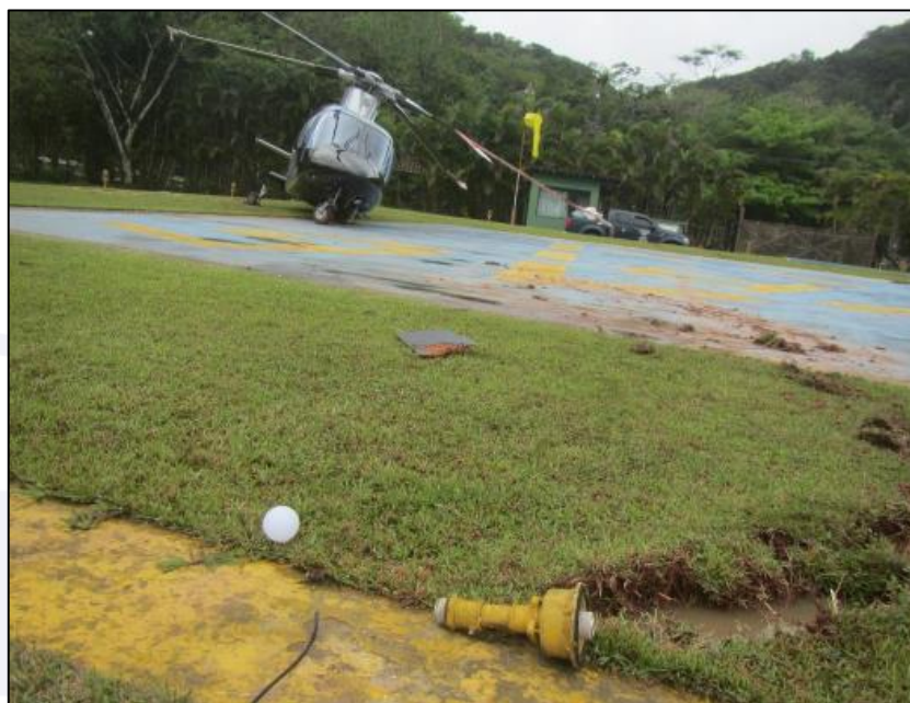
Figura 2 - Danos no balizamento do heliponto.
