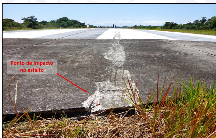
Figura 2 - Ponto de impacto do trem de pouso contra o concreto do início da pista.
