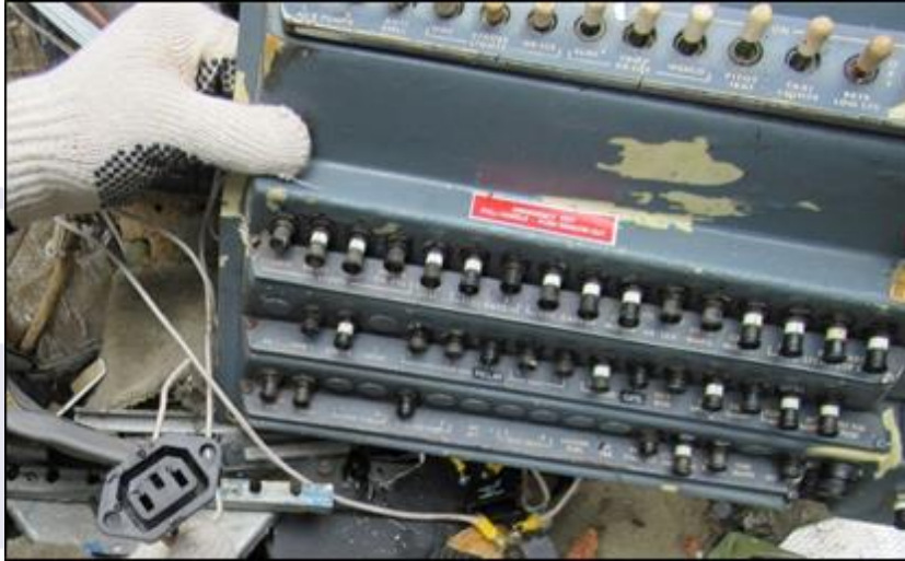
Figura 4 - Painel de disjuntores contendo tomada e ligações elétricas não certificadas.
