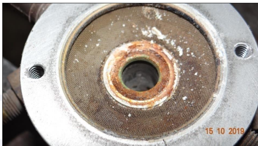
Figura 12 - Vista da corrosão no filtro de combustível interno do distribuidor.
