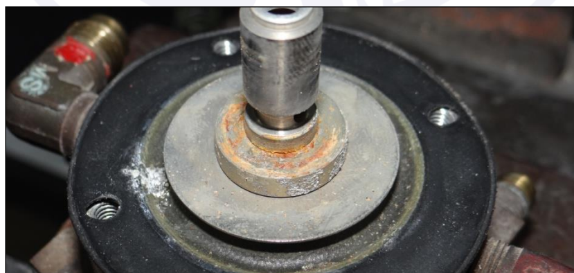
Figura 11 - Vista do pistão do diafragma emperrado por corrosão.
