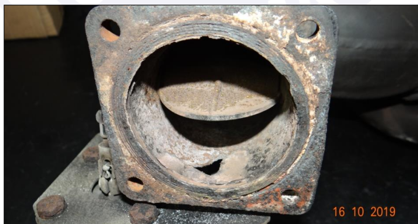
Figura 14 - Vista da corrosão severa na parte interna do corpo da borboleta.
