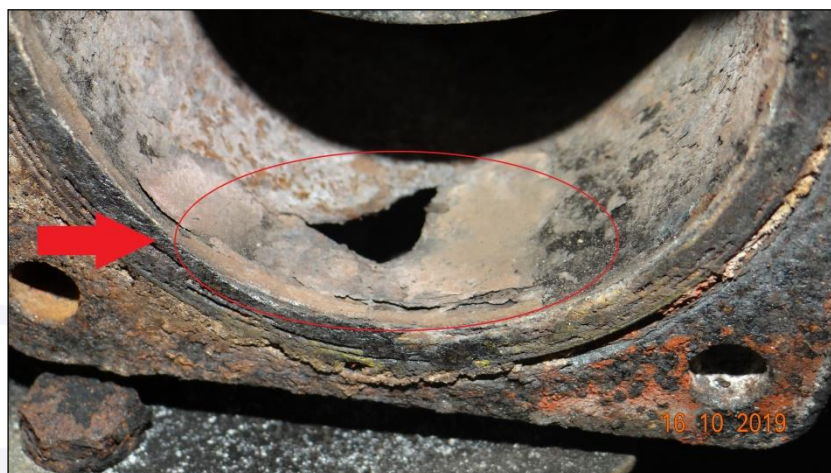
Figura 15 - Vista da trinca e furo observado no interior do corpo da borboleta, causado por corrosão severa.
