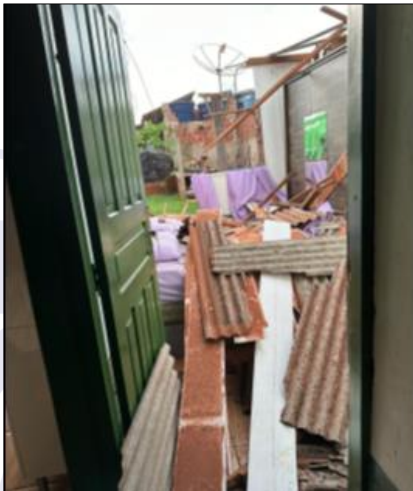
Figura 5 - Residência danificada com a queda do balão.
