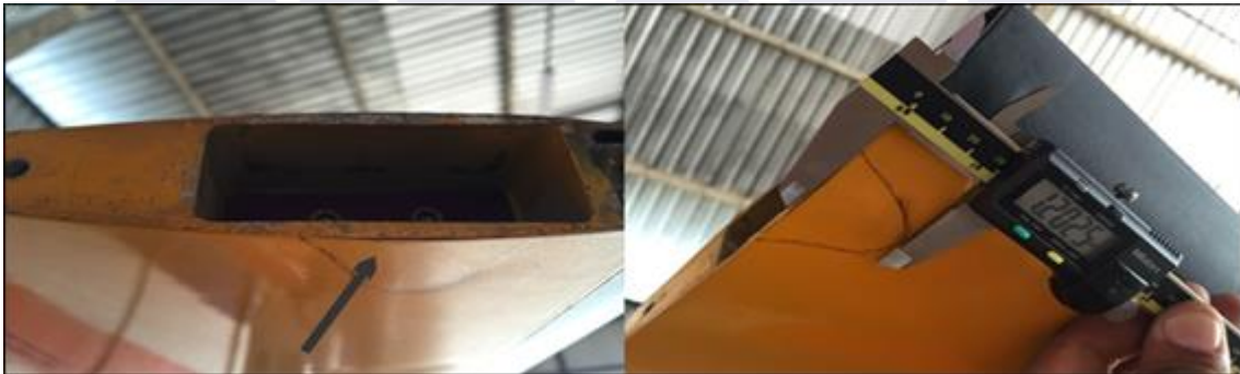
Figura 3 - Descolamento da camada externa ( skin ) da pá do rotor principal, SN 6845.
