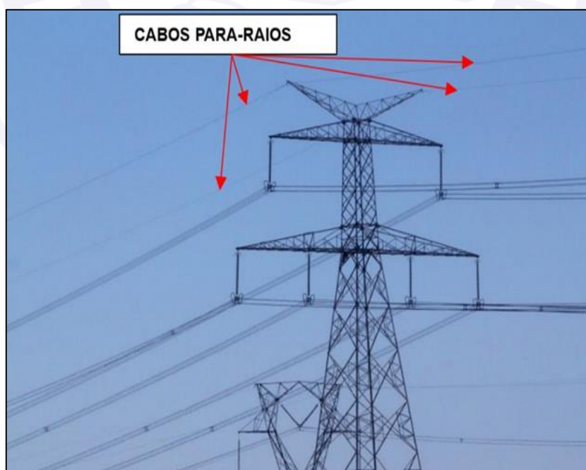
Figura 13 - Imagem ilustrativa de cabos para-raios na parte superior de uma LT.
