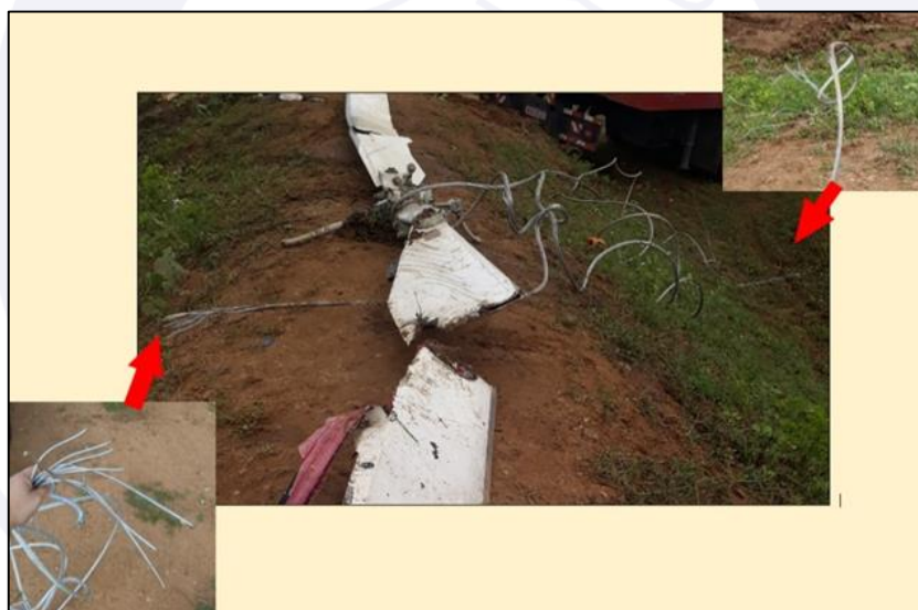
Figura 17 - Segmento do cabo para-raios rompido em dois locais (extremidades em destaque).
