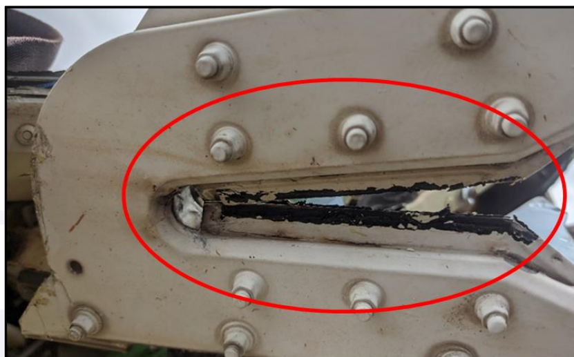
Figura 23 - Corta fios superior com evidências de contato com o cabo para-raios.
