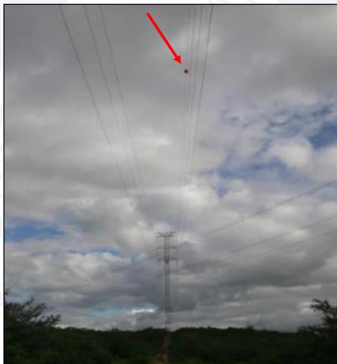
Figura 36 - Esfera de sinalização nº 2 da LT 230 kV.
