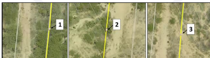
Figura 34 - Identificação das esferas de sinalização dos cabos elétricos 1, 2 e 3, respectivamente, da LT 230 kV.
