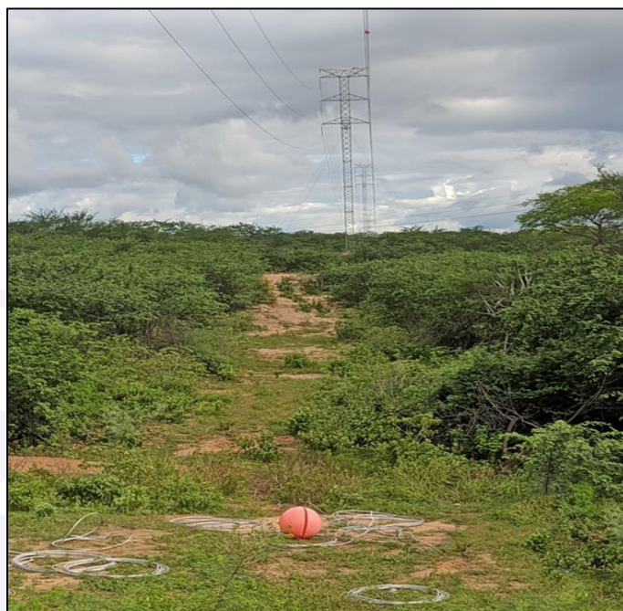
Figura 35 - Esfera de sinalização nº 1 no solo, devido ao rompimento do cabo para-raios da LT 230 kV.
