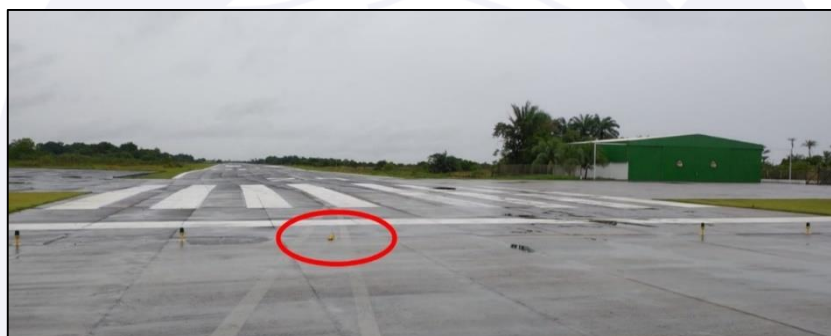
Figura 19 - Iluminação da pista quebrada.
