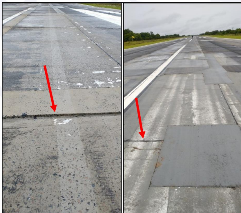
Figura 12 - Pavimento com desnivelamento de placas.
