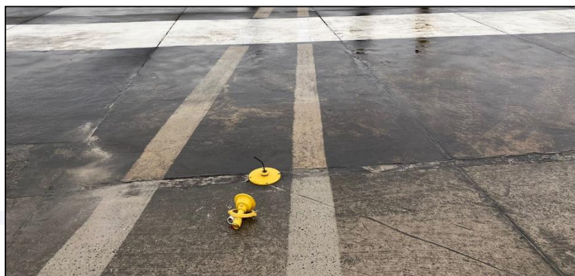
Figura 5 - Luz de limite de pista quebrada.
