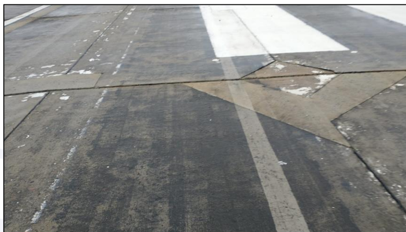
Figura 13 - Pavimento com indícios de acúmulo de detritos (aspecto de lodo).
