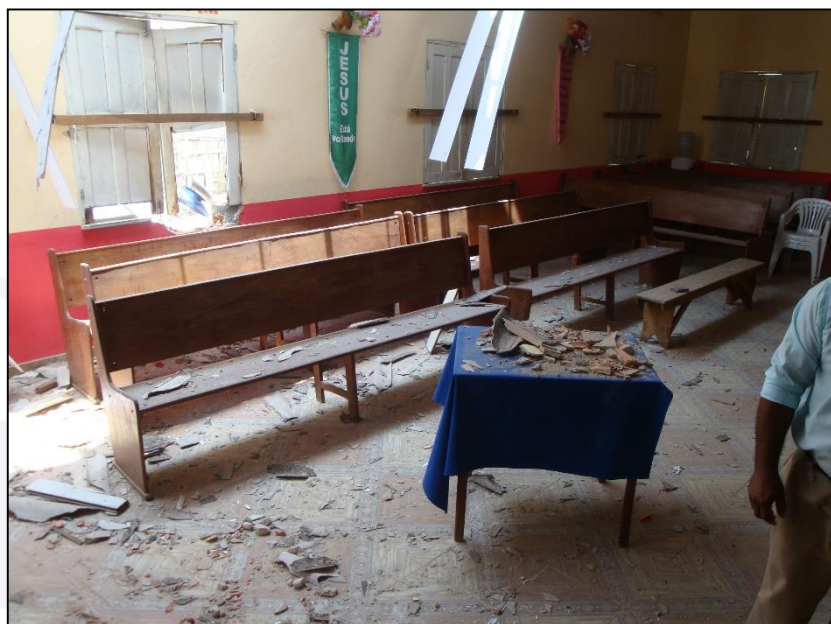
Figura 3 - Danos no interior da igreja.
