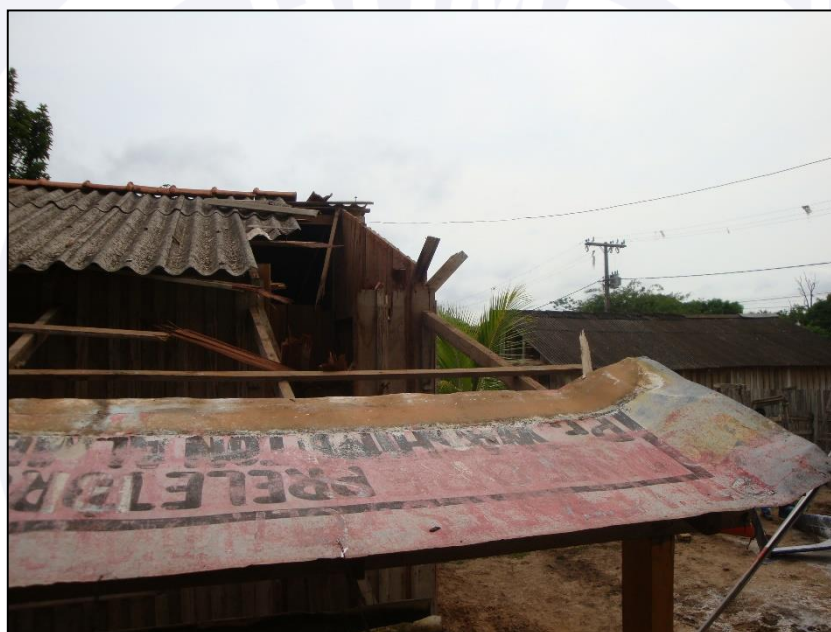
Figura 4 - Danos ao telhado da casa.
