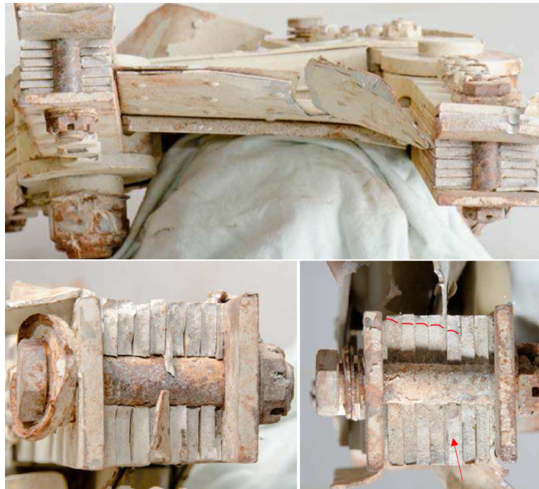
Figura 41: PT-GUR. Detalhe da região fraturada da longarina apresentando corrosão generalizada.
