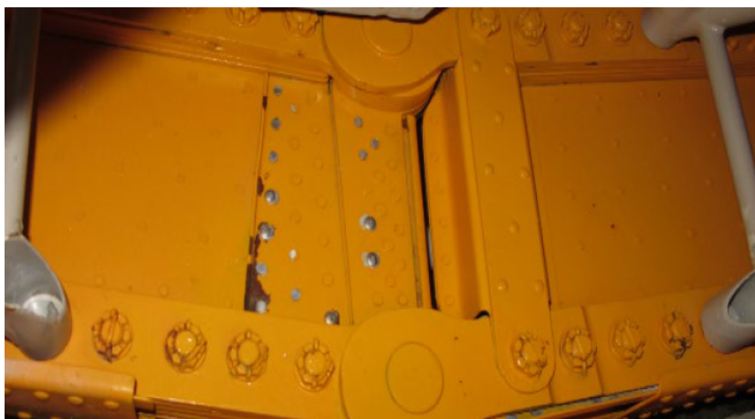
Figura 106: Vista posterior da junção das longarinas com corrosão na alma e nos prendedores de 1/2 pol. Figura 13 do BS 200-057-0013.
