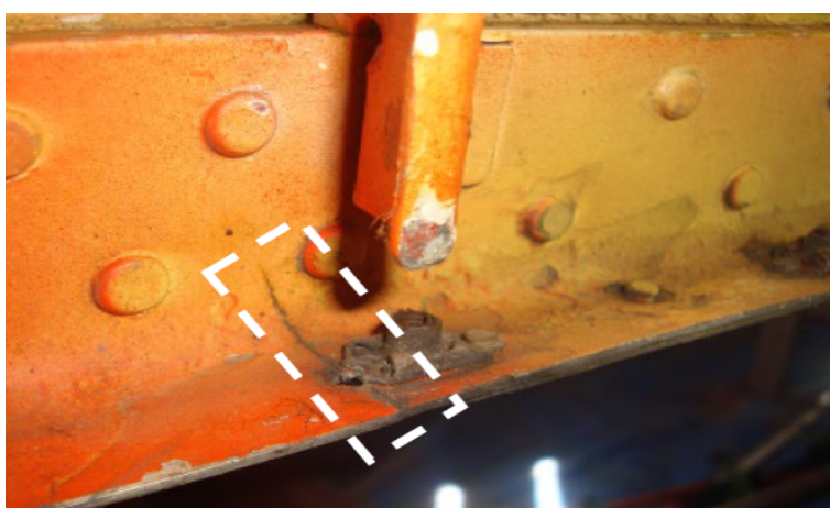
Figura 109: Perfil L trincado. Figura 15 do BS 200-057-0013.
