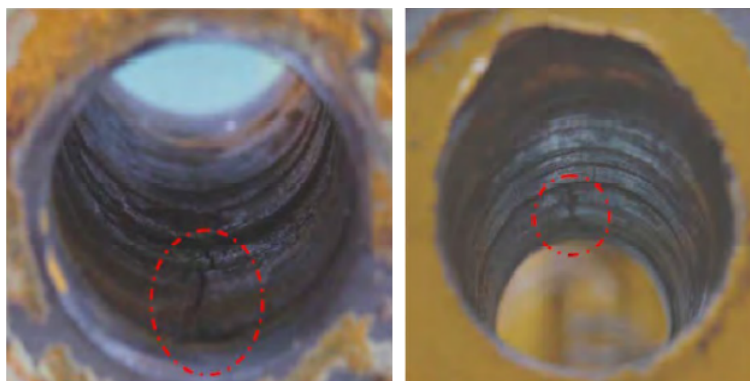
Figura 89: Furos de 1/2 pol apresentando trinca. Observa-se que a trinca inicia nas regiões superior e/ou inferior do furo, propagando em direção praticamente vertical, sentido para cima e/ou para baixo, respectivamente. Figura retirada do Boletim de Serviço BS 200-057-008.
