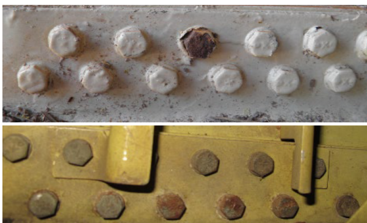
Figura 110: Prendedores de 3/16 pol com corrosão. Figura 16 do BS 200-057-0013.
