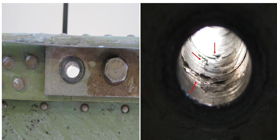
Figura 118: Vista interna ao 5º furo de 1/2 pol após remoção do pino. É possível observar os amassamentos e lasqueamento da superfície interna dos furos, em especial nas quinas de interface das chapas.
