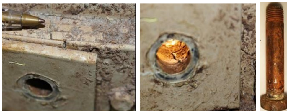
Figura 33: PT-GSB. Fotografia indicando a presença de trincas na furação do 5º pino da mesa inferior da semiasa esquerda também, em propagação. Corrosão generalizada encontrada nos pinos de 1/2 pol.
