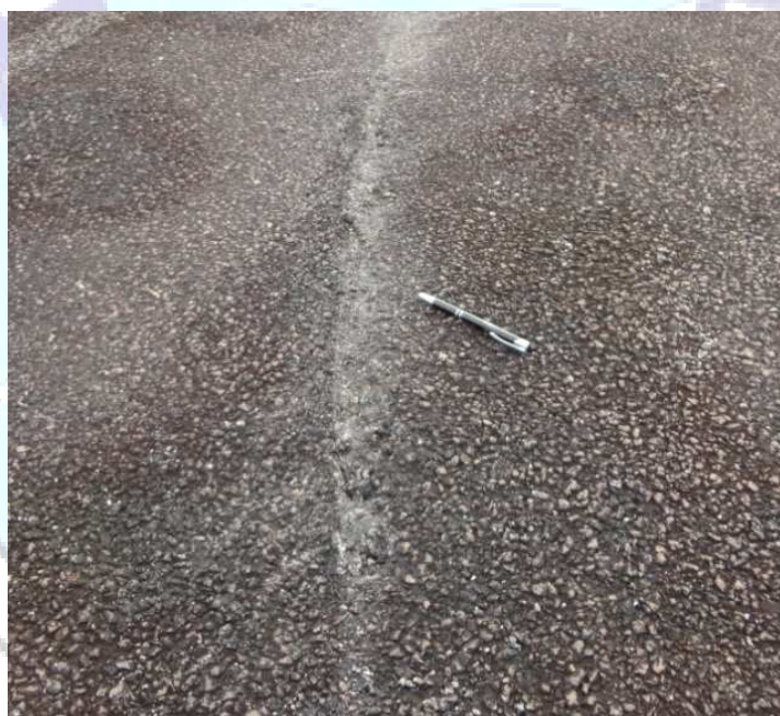
Figura 3 - Marca deixada pelo contato do metal da roda no asfalto.
