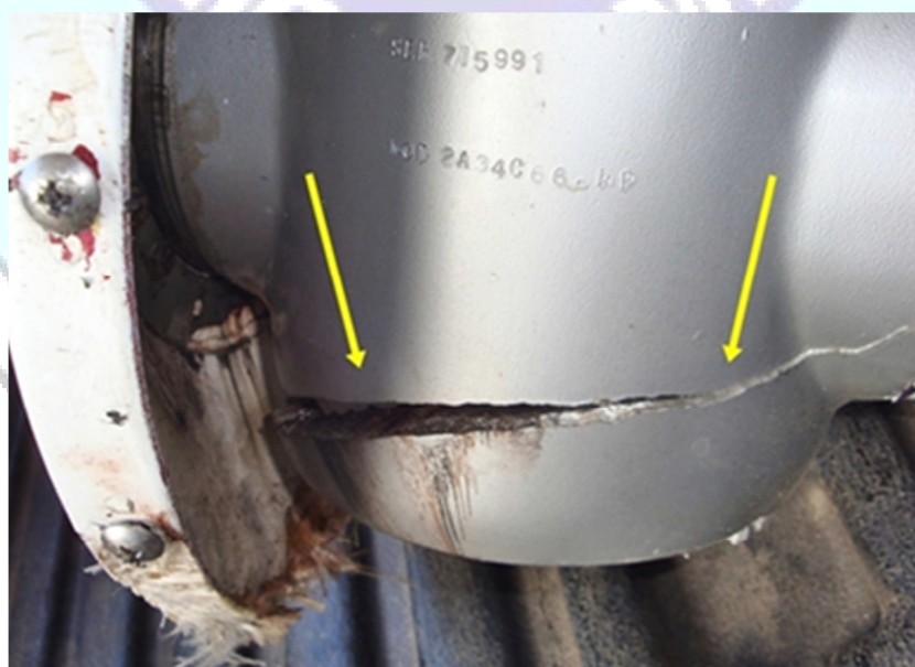
Figura 3 - Cubo da hélice com ruptura na fixação da pá.
