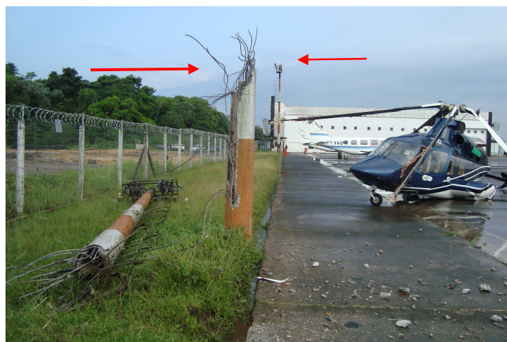
Figura 5 - Torres de iluminação na extremidade do pátio.
