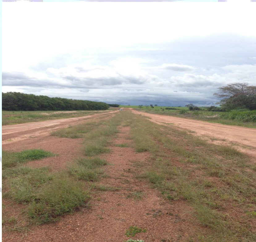
Figura 3 - Estado da pista no dia da ocorrência. |
