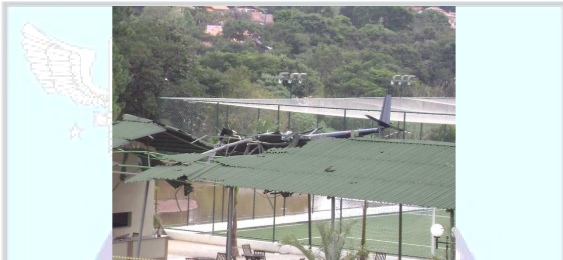
Figura 4 - Detalhes do helicóptero preso à estrutura da edificação.
