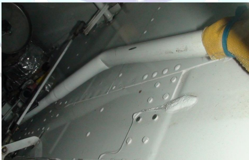
Figura 3 - Dano na haste-guia da retração do trem auxiliar.
