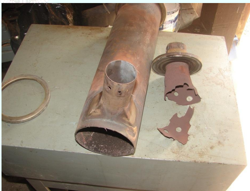
Figura 2 – Vista do tubo corta-chama deteriorado e partido.
