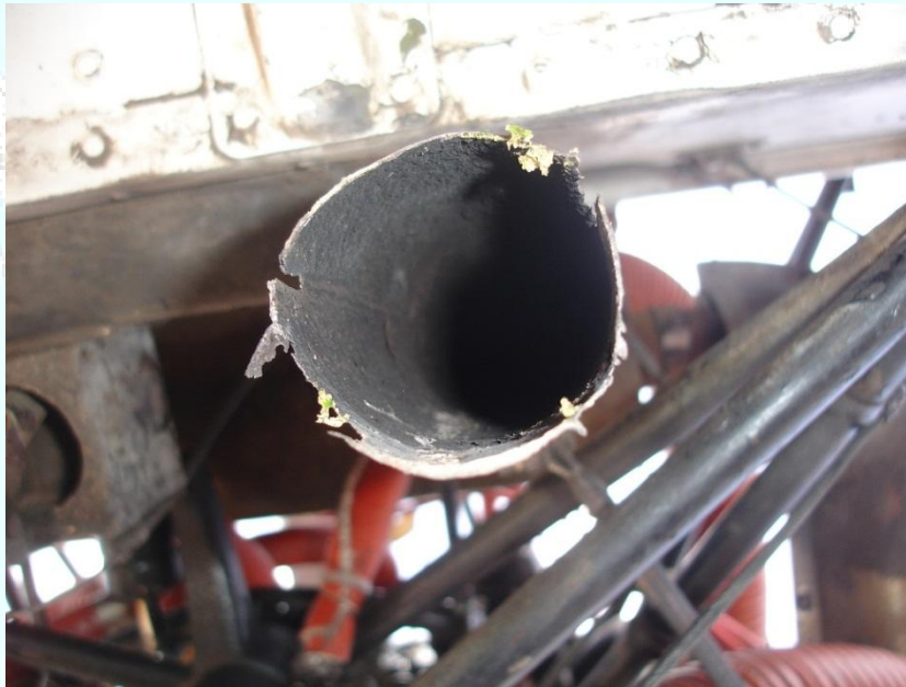
Figura 4 – Vista do tubo de escapamento do sistema de exaustão.
