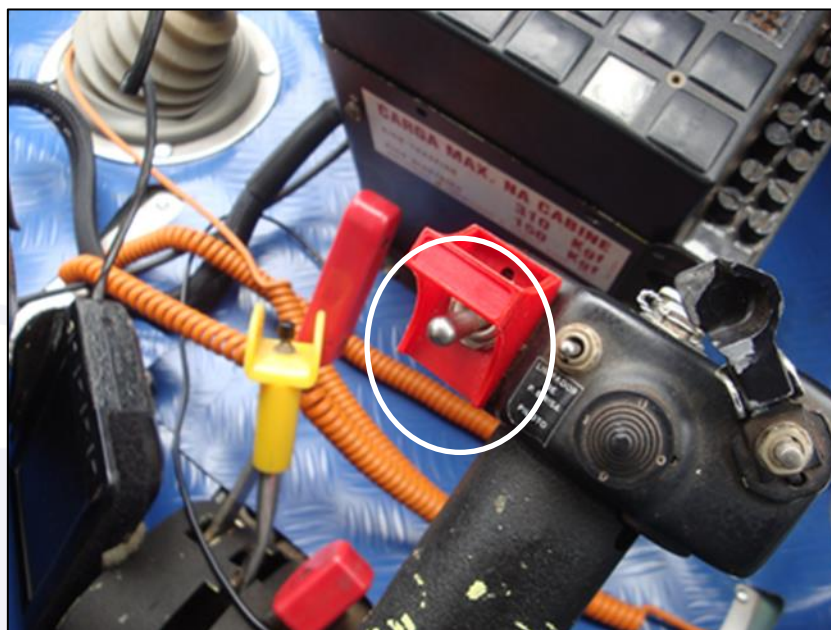
Figura 6 - Chave de corte do sistema hidráulico em OFF.
