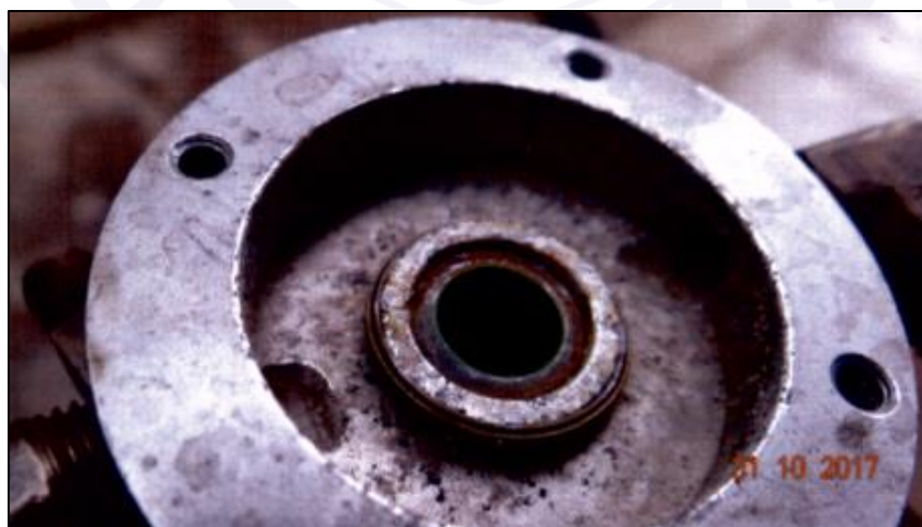
Figura 6 - Corrosão observada na válvula distribuidora.
