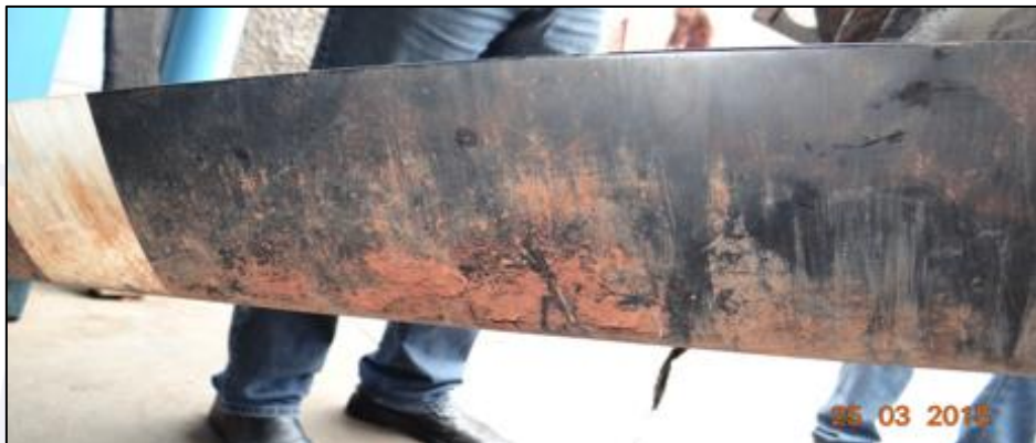
Figura 3 - Vista da hélice com terra depositada ao longo das pás.
