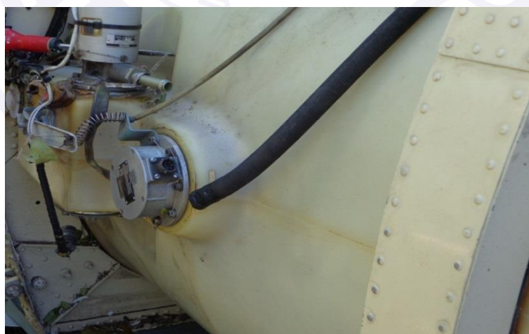
Figura 11 - Mangueira de combustível.
