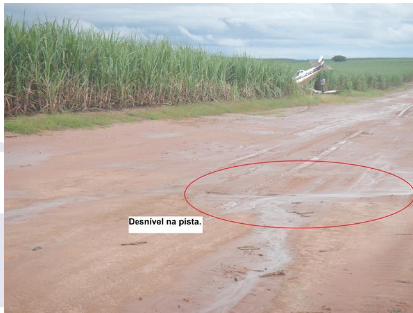
Figura 2 - Vista do desnível na pista.
